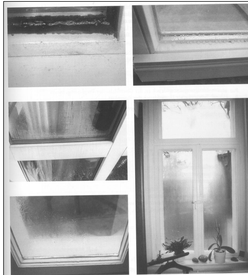
Abb. 4.45 a-e: Tauwasserausfall auf der raumseitigen Scheibenoberfläche von isolierverglasten Fenstern weist auf eine überhöhte Raumluftfeuchtigkeit hin.
