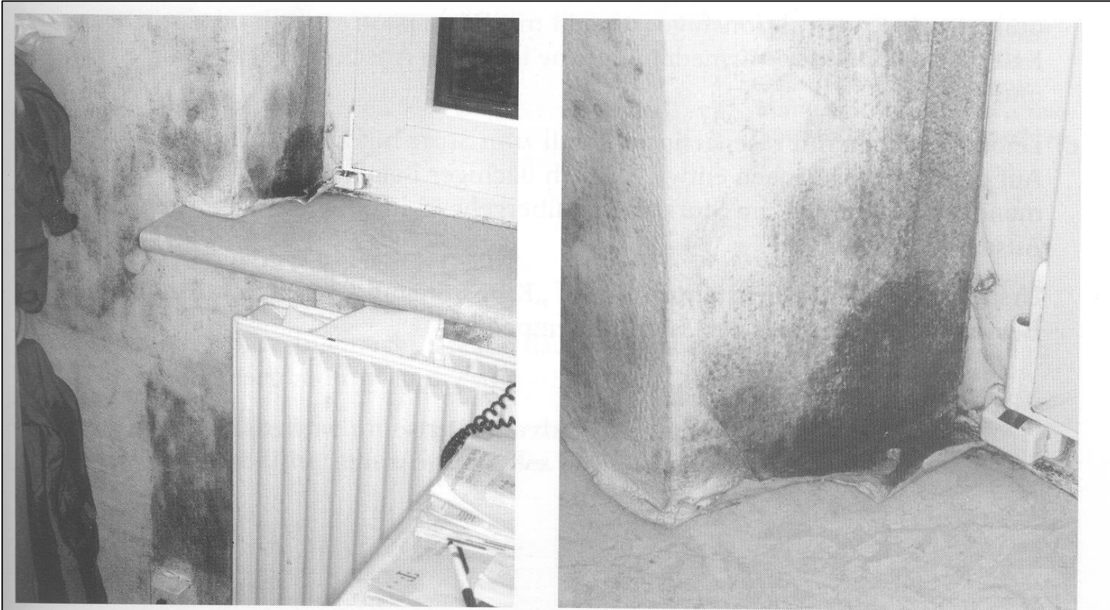
Abb. 4.7 a und b: Dominante Schimmelpilzrasenbildung im unteren Leibungsdreieck und neben dem Heizkörper sind Indiz für einen Tauwasserausfall aufgrund zu geringer Beheizung.
